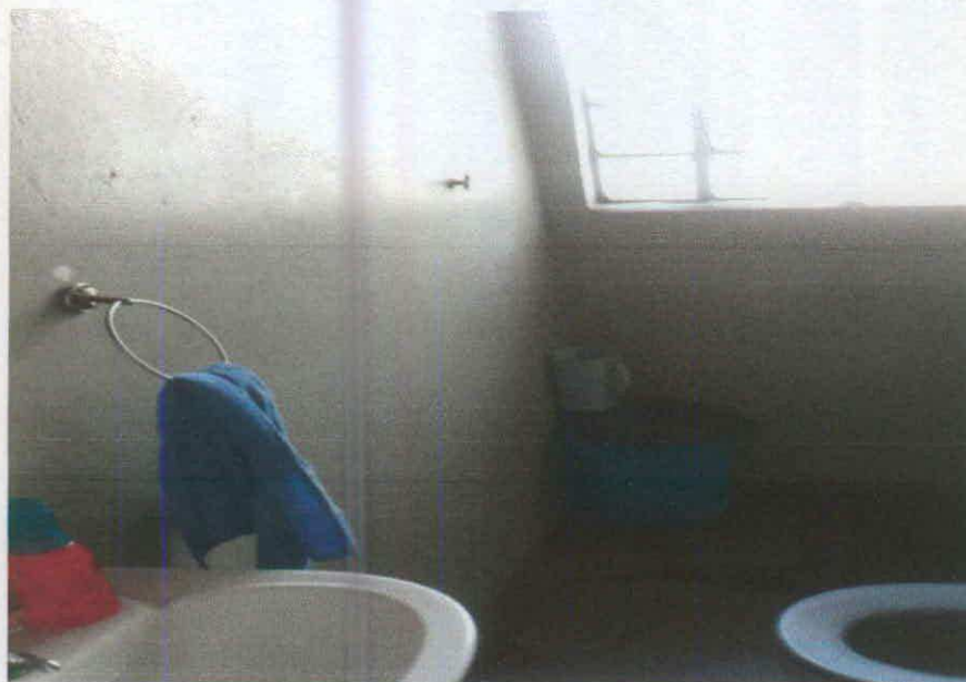
BANHEIRO PAV. SUPERIOR - SEM ACESSIBILIDADE.
