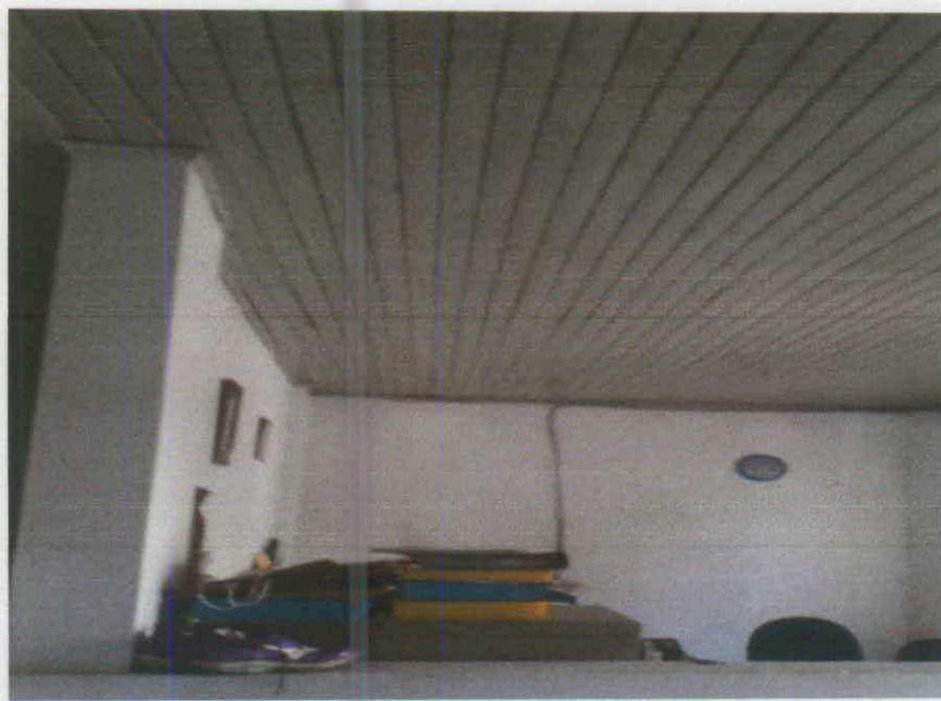
OUTRA VISTA DO ESCRITÓRIO - PAV.SUPERIOR - FORRO EM MAU ESTADO DE CONSERVAÇÃO
