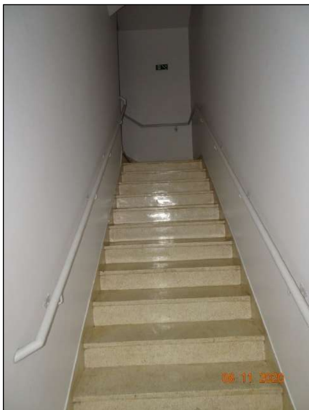
Foto 25. Vista da escadaria do Edifício Santa Rita, integrante do empreendimento "Condomínio Chácara Santa Elena".
