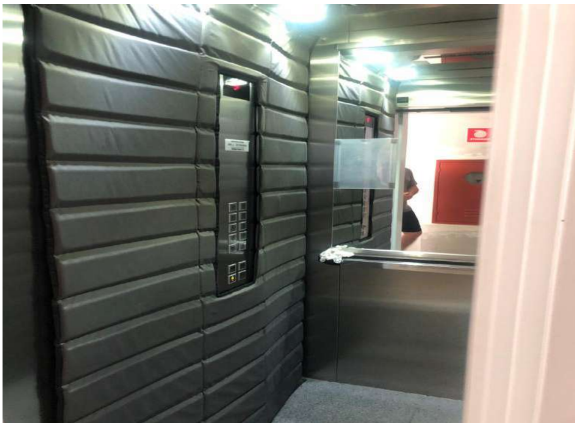
Visão interna do elevador
